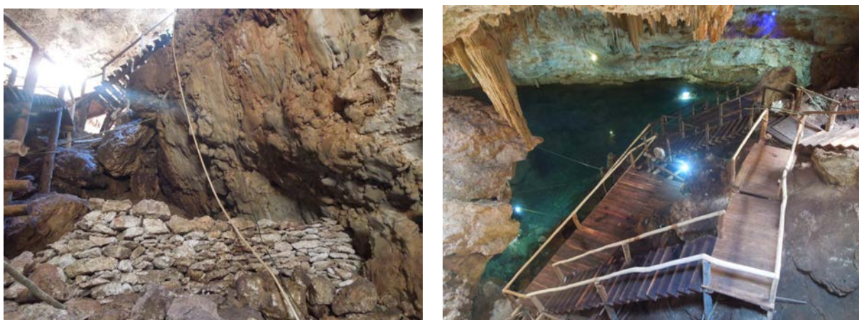
Figura 114.- Cenote Fantasma, XCatzin, Chemax, muestra la improvisación del muro para guardar las instalaciones eléctricas. Figura 115.- Infraestructura de madera para acceder al cenote. Fotos: Fátima Tec.
