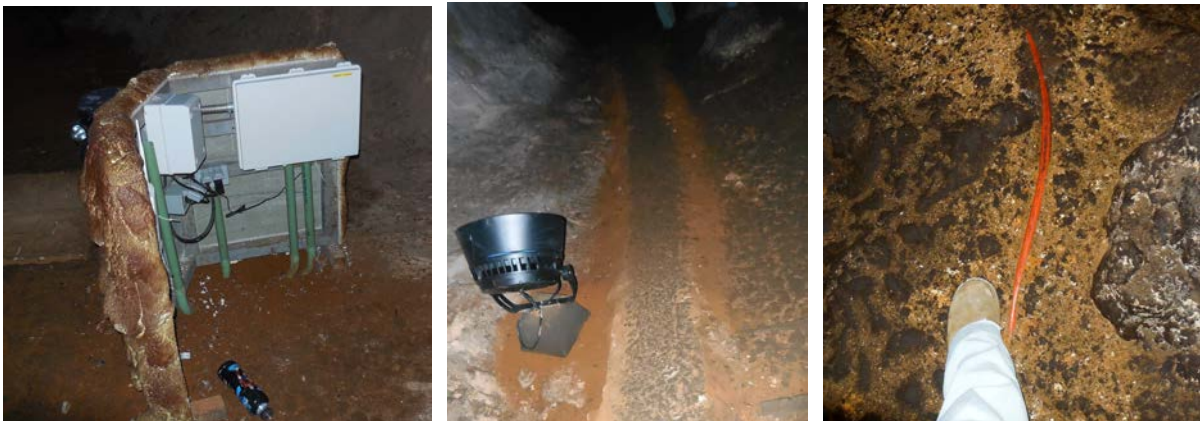
Figura 112.- Instalaciones en la caverna: muros que simulan una pared, lámparas y el cable de luz eléctrica semienterrado. Fotografías: Carlos Evia.
