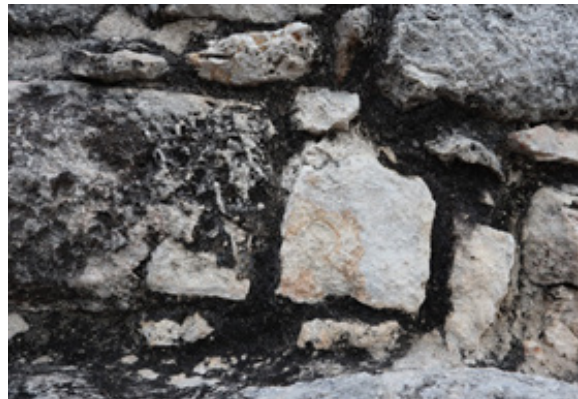
Figura 62: Costra negra en material pétreo y junta de cemento (JMS).
