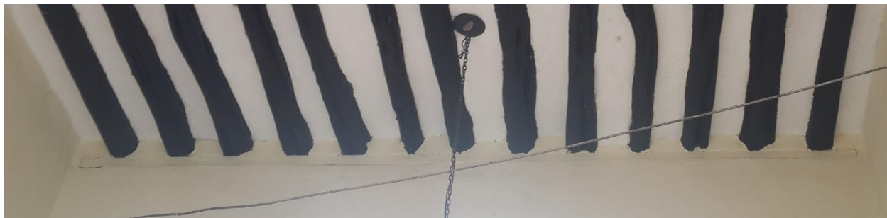
Figura 93: Detalle. Viga de arrastre. Techos actuales de la biblioteca. Cubierta plana de Rollizos. Foto: Autora.
