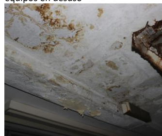
Afectaciones al plafón por filtraciones
