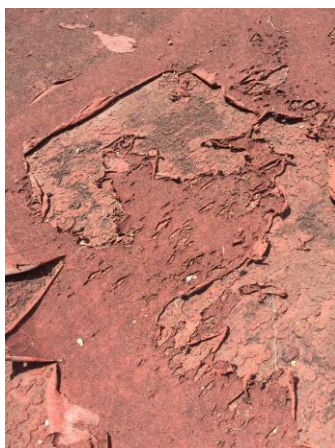
Desprendimiento del impermeabilizante acrílico
