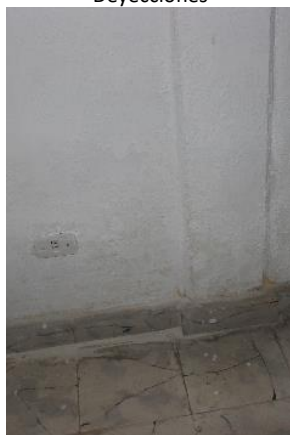
Eflorescencias por humedad capilar
