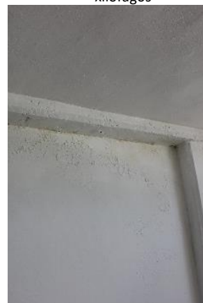
Eflorescencias por filtraciones
