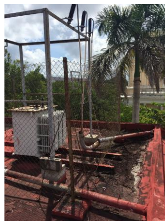
Acumulación de materia orgánica y equipos en desuso
