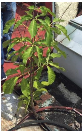
Presencia de vegetación en la azotea
