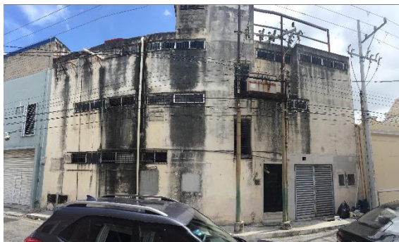
Fachada oriente del edificio marcado con el número 483 A sobre la calle 58
