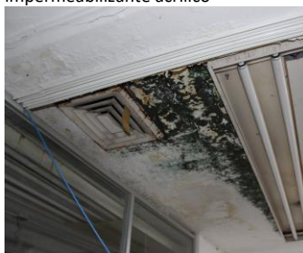
Filtraciones por los ductos del aire acondicionado
