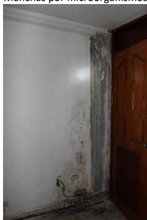
Humedades por filtraciones
