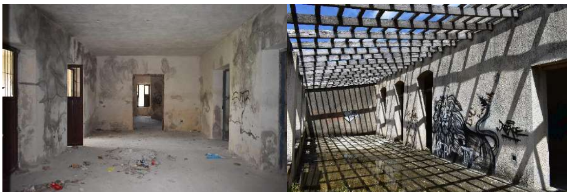
Ilustración 59. Fotografías de estado general de muros interiores (espacio B4) y de muros exteriores (espacio A6) del edificio Xculucya 2017. Fuente: Elaboración propia.
