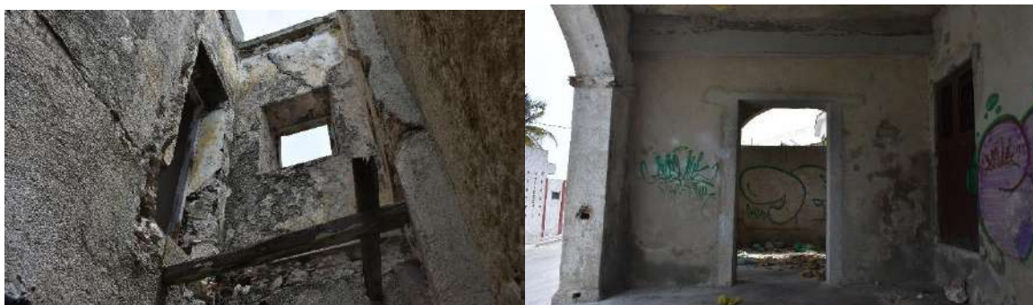
Ilustración 71. Fotografías del baño demolido sobre la fachada oriente en planta alta y muro doble de block entre espacios B1 y B2 del edificio Xculucya 2017. Fuente: Elaboración propia.
