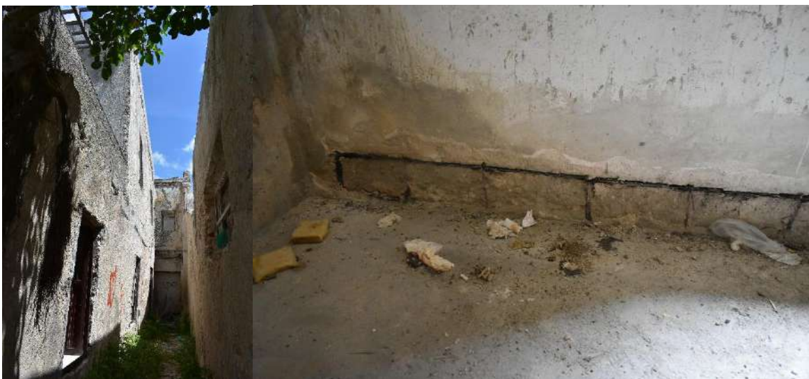
Ilustración 72. fotografías del muro desplomado de la fachada oriente y de la cadena de muro gravemente deteriorada (espacio B7) del edificio Xculucya s017. Fuente: Elaboración propia.
