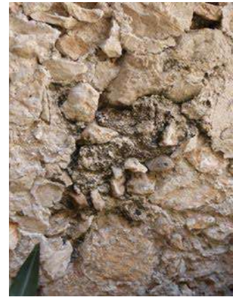
Mortero incompatible en muro del patio claustro.
