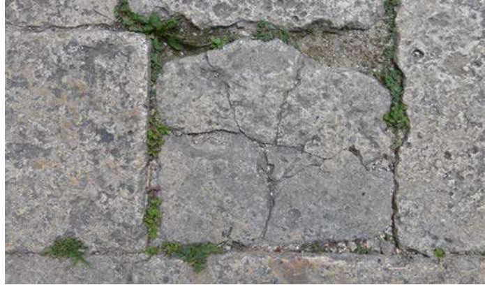
Faltante en sillar del pavimento del patio claustreal.
