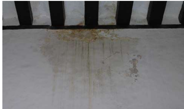
Afectación en el muro del segundo nivel del corredor oeste.
