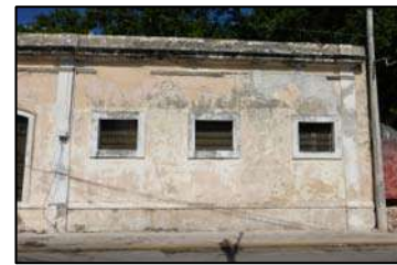
PATINA DISPERSA Y DESPRENDIMIENTO DE ACABADOS
