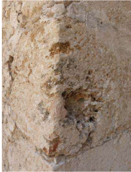
Detalle de alveolización en un contrafuerte del patio claustral.
