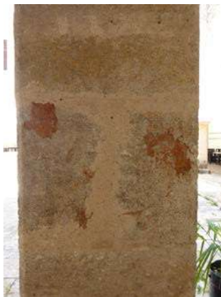
Morteros incompatibles en pilar del claustro.
