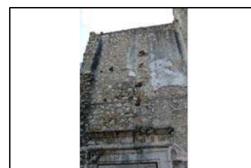
OQUEDADES, PÉRDIDA E ACABADOS Y COSTRA BIOGÉNICA
