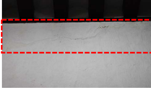
Detalle de fisura en muro del claustro alto.
