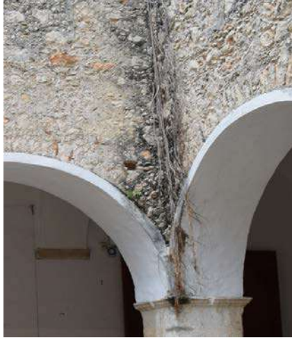
Raíces incrustadas en la esquina SE del patio claustral
