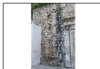
OQUEDADES, PÉRDIDA E ACABADOS Y COSTRA BIOGÉNICA
