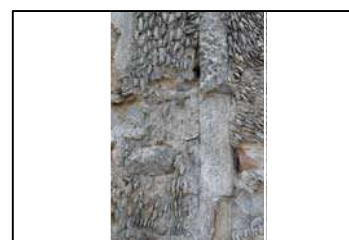
DESPRENDIMIENTO DE ACABADOS
