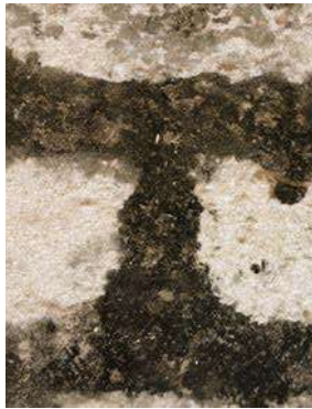
Afectación en pilar del patio claustral.
