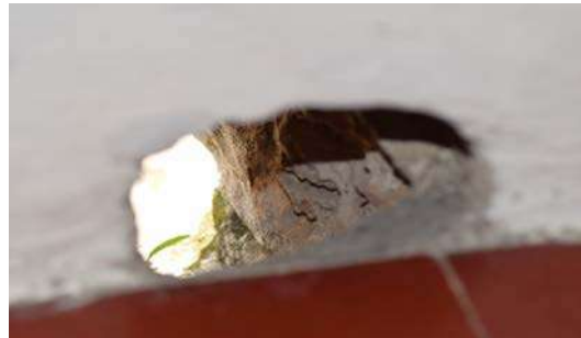
Afectación en corredor oeste del claustro alto
