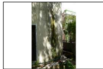
MANCHAS DE HUMEDADES
