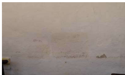
Presencia de eflorescencia en muro del corredor oeste del claustro.
