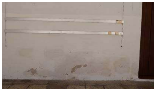
Presencia de eflorescencia en muro del corredor norte del claustro bajo.
