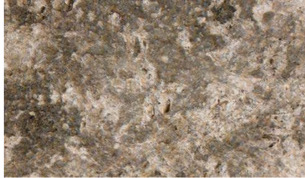
Detalle de micro karstificación en pilar del claustro bajo.
