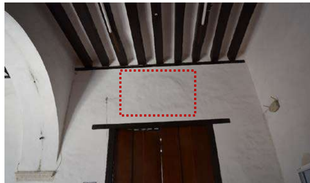
Afectación en el corredor este del claustro alto.
