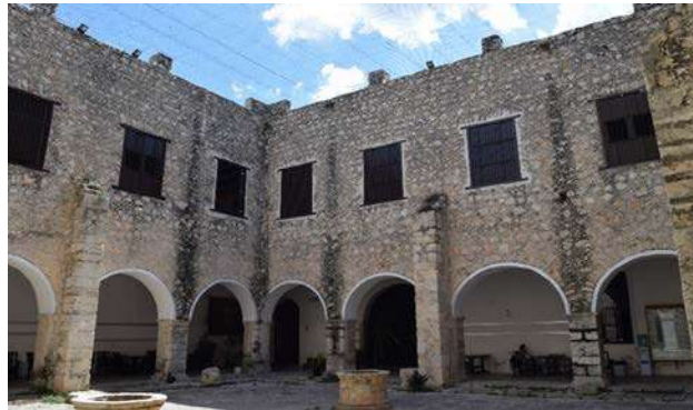
Perdida de acabado en las fachadas sur y este del patio claustal.
