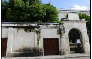
ADOSAMIENTO, COSTRA BIOGÉNICA Y COSTRA NEGRA
