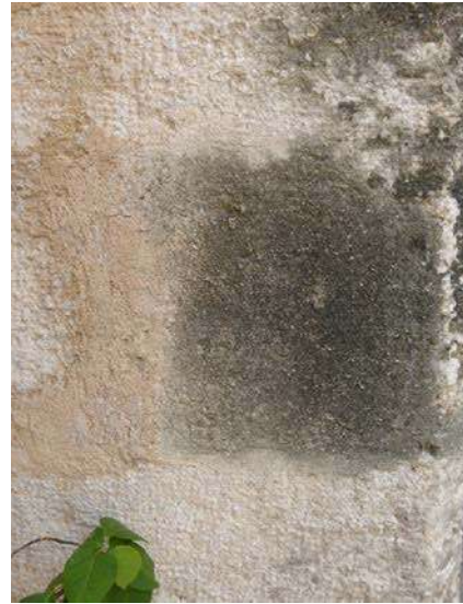
Afectación en pilar del patio claustral
