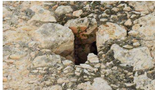
Afectación en la fachada norte del patio claustral
