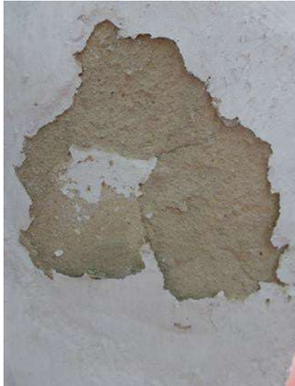
Desconchamiento de pintura en el corredor sur del claustro bajo.
