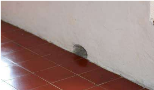
Afectación en corredor este del claustro alto
