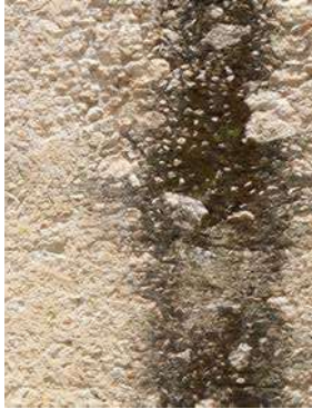
Afectación en el muro sur exterior del patio claustral.
