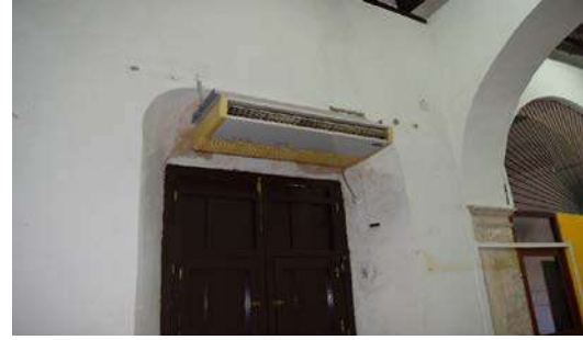
Aire acondicionado adosado en capialzado de una de las ventanas del corredor oeste del claustro alto.
