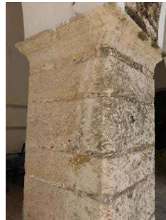
Afectación en pilar del patio claustral.
