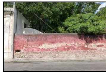
DESPRENDIMIENTO DE ACABADOS
