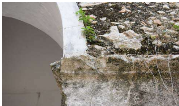
Detalle de desconchadura pétrea en capitel de un pilar del claustro.
