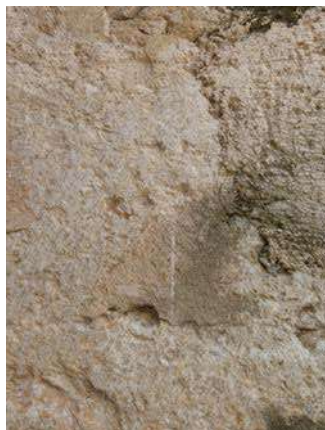
Afectación en pilar del patio claustral.
