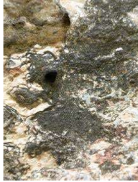
Afectación en pilar del patio claustral.
