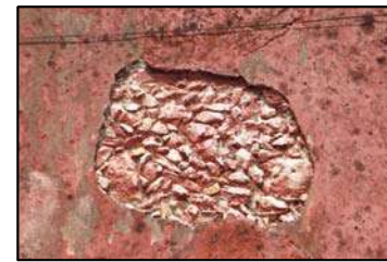
DESPRENDIMIENTO DE ACABADOS
