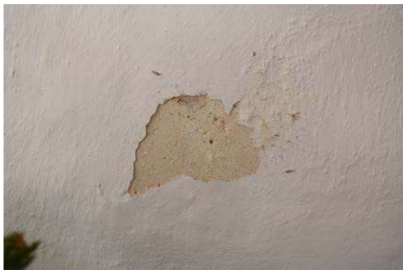
Desprendimiento de acabados en muro del corredor norte.
