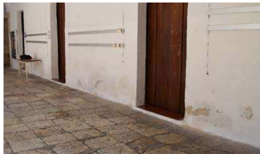
Presencia de eflorescencia en muro del corredor norte del claustro bajo.
