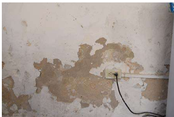
Desprendimiento de acabados en muro del corredor este.
