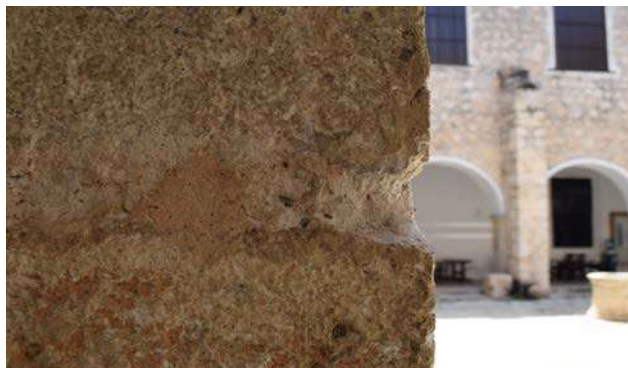
Detalle de desconchadura pétrea en pilar del claustro bajo.
