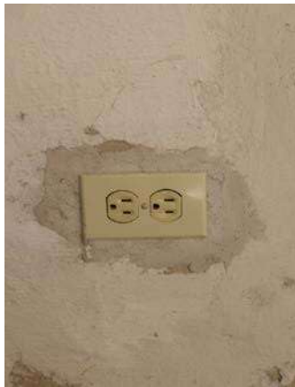
Utilización de morteros inadecuados para colocar instalaciones.
