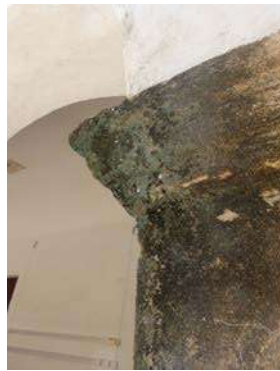
Afectación en pilar del patio claustral
