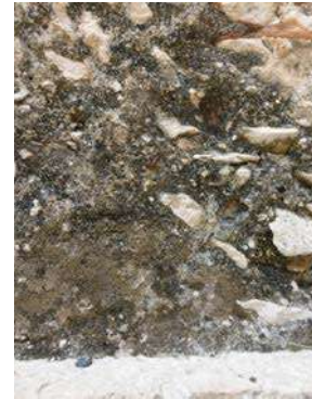
Afectación en muro norte del patio claustral
