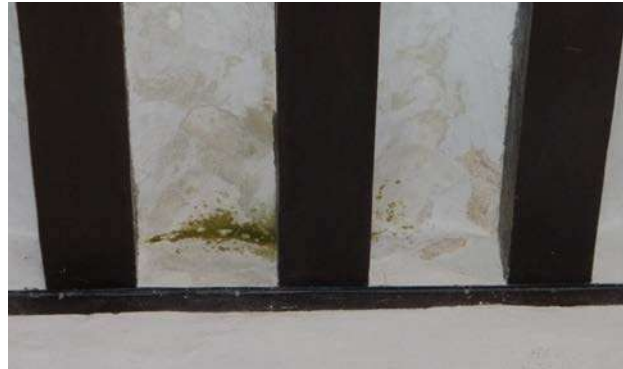
Afectación en el plafón del segundo nivel del corredor norte.
