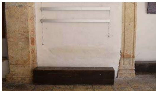
Presencia de eflorescencia en muro del corredor oeste del claustro bajo.
