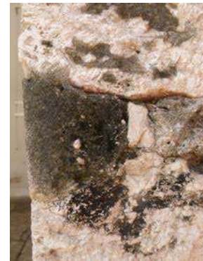
Afectación en pilara del patio claustral.
