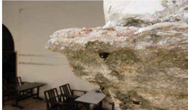
Detalle de mikro karstificación en capitel de un pilar del claustro bajo.
