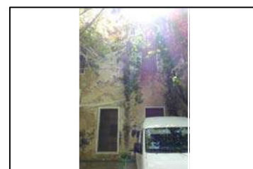
PÉRDIDA DE ACABADOS, COSTRA BIOGÉNICA
