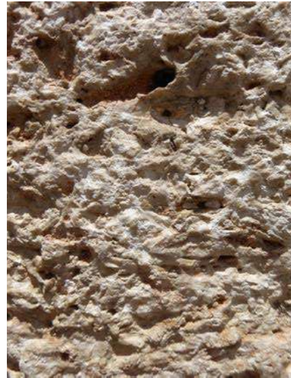
Detalle de alveolización en pilar del patio claustral.
