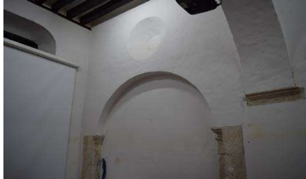
Afectación en el corredor oeste del claustro alto.
