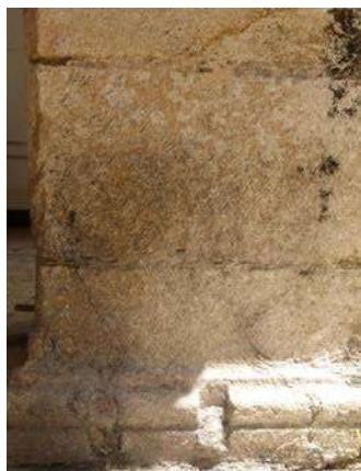
Afectación en pilar del patio claustral
