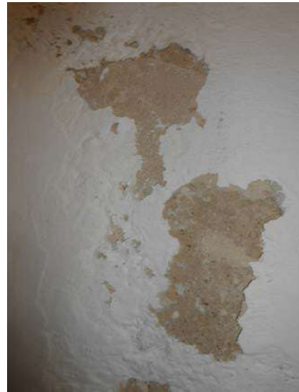
Desconchamiento de pintura en el corredor norte del claustro bajo.
