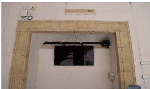
Televisión adosada en vano tapiado del corredor sur del claustro bajo.
