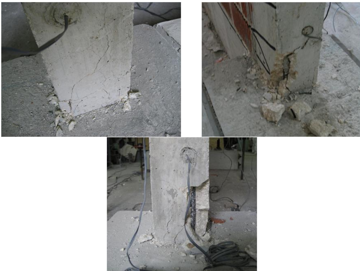
Figura 4.6 Aplastamiento del concreto en castillos.
