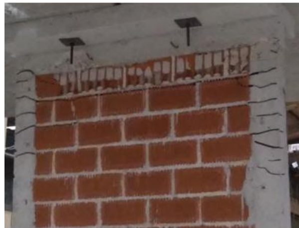
Figura 4.5 Aplastamiento de la mampostería.
