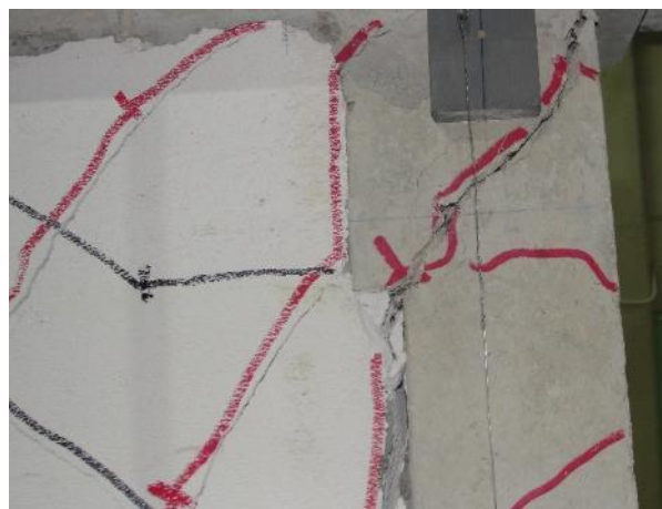
Figura 4.12 Agrietamiento diagonal en la esquina superior del castillo derecho del muro Mc4
