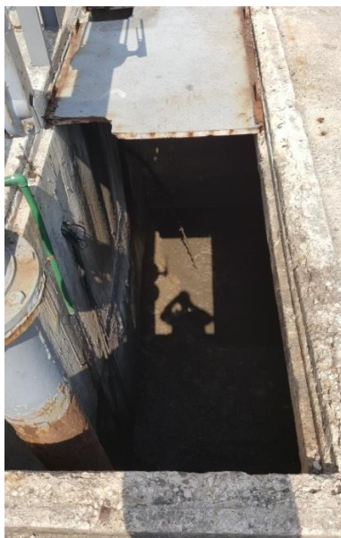
Figura 2. Cárcamo de bombeo
