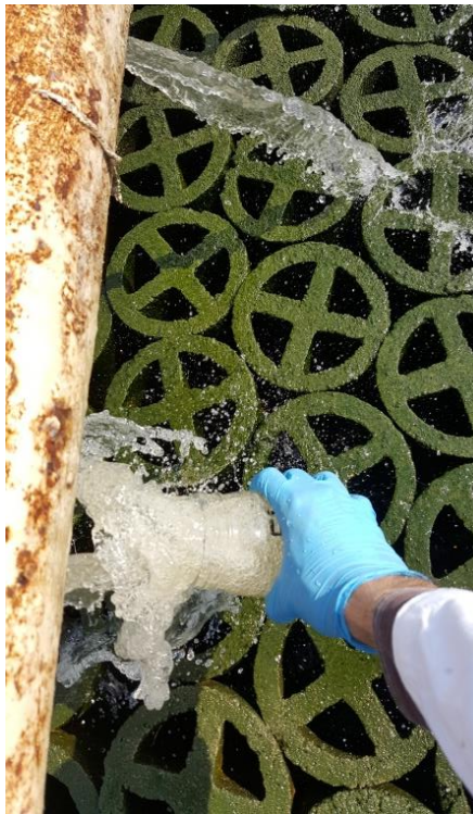
Figura 8. Toma de muestra del filtro percolador.
