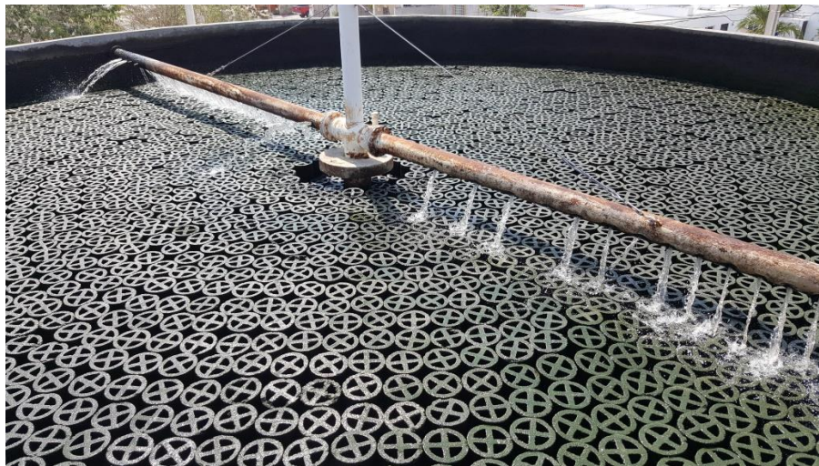
Figura 5. Filtro percolador de la planta de tratamiento
