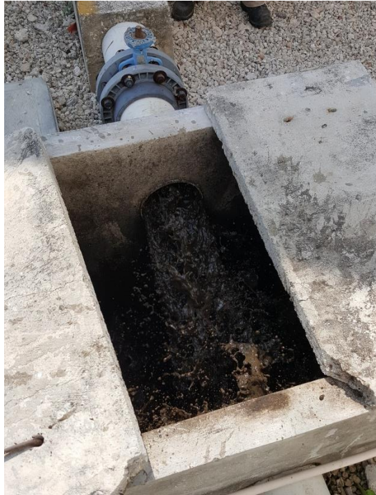
Figura 7. Recirculación del sedimentador del segundo filtro.
