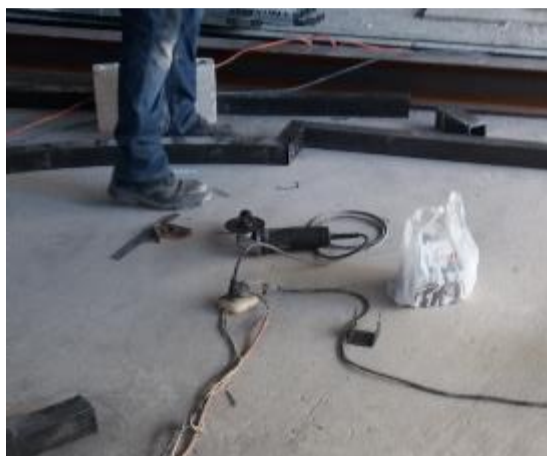
Figura 12. Cables expuestos en extensiones eléctricas
