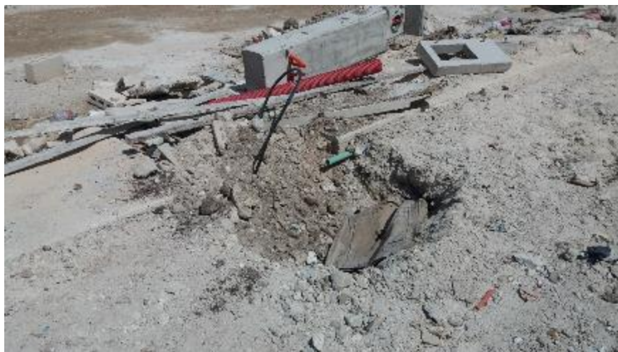
Figura 15. Excavación sin delimitación
