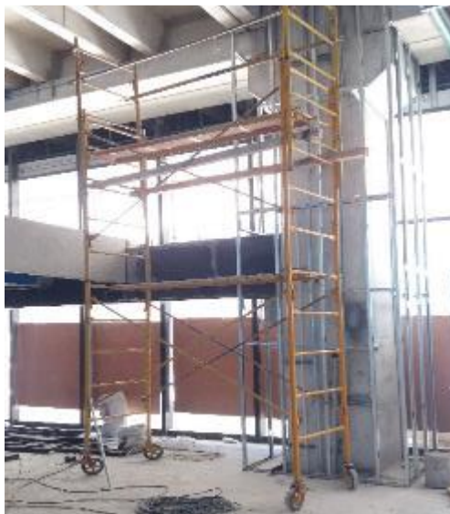
Figura 8. Andamios con ruedas y plataformas metálicas
