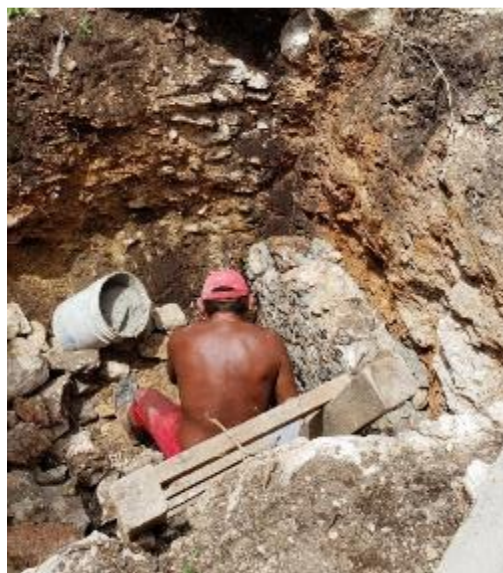
Figura 11. Trabajador realizando actividades sin ropa adecuada
