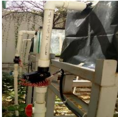
Figura 6. Válvulas solenoides controladoras del flujo de entrada al sistema de humedales artificiales híbridos.
