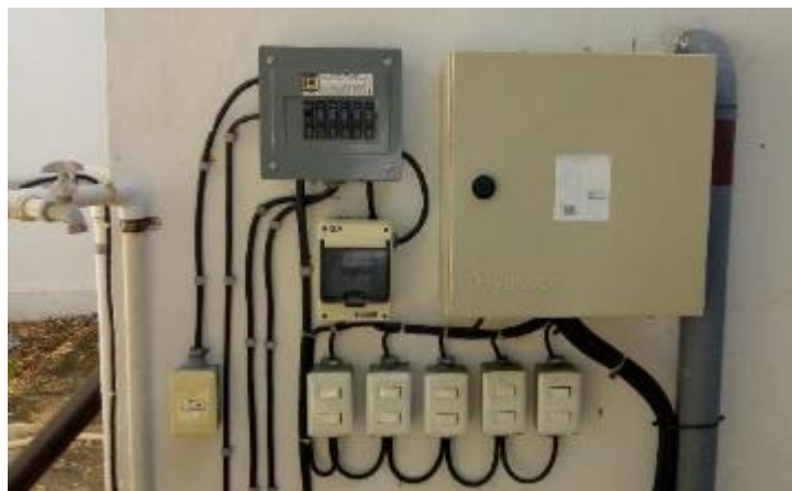
Figura 5. Sistema eléctrico para controlar el flujo al sistema de humedales artificiales híbridos.
