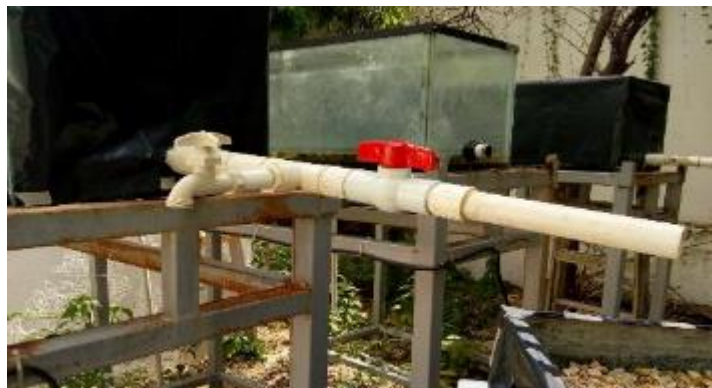
Figura 7. Instalación hidráulica para descarga y toma de muestras.
