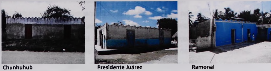
Imagen 4.59. Viviendas con techumbres de asbesto. Quintana Roo, México.
