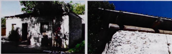
Imagen 4.58 Cubierta inclinada de un agua: estructura de madera y lámina de zinc sobre muros de mampostería ordinaria.
