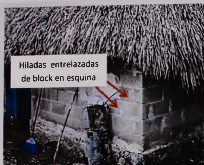
Imagen 4.22. Muros de block sin apoyos en esquinas. Ubicación: Sabana San Francisco, Q. Roo, México Fuente: Imagen propia.
