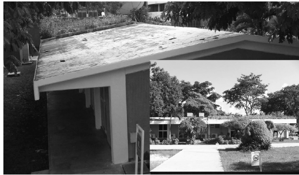
Figura 4. El techo del edificio de salas audiovisuales 1 (recinto con techo verde al fondo) y 2 (recinto con techo blanco al frente) de la FIUADY después de más de tres años del inicio del experimento. Es evidente el deterioro notable en el albedo del techo blanco causado por el medio ambiente. En el recuadro inferior se puede apreciar el contexto de ambas salas.
